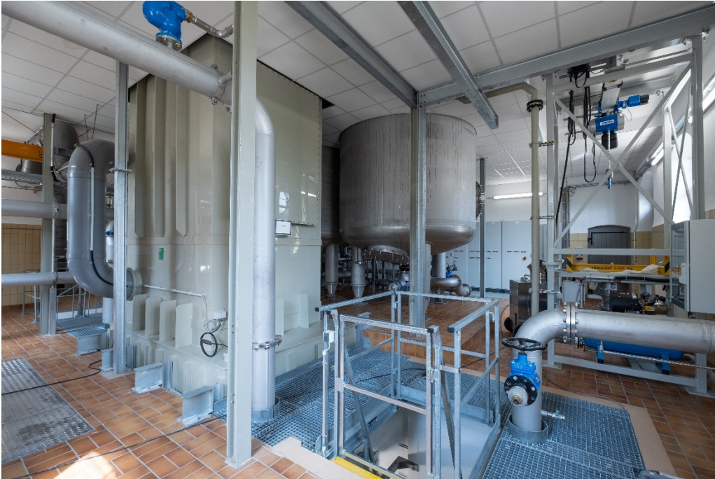
Bild 10: PFC-Filtertechnik im Wasserwerk Rauental. Die Aufrüstung des Wasserwerks Rauental mit dieser effizienten Filtertechnik ist wohl das zentralste Element im Kampf gegen PFC. Bildnachweis: Stadtwerke Rastatt, Oliver Hurst
