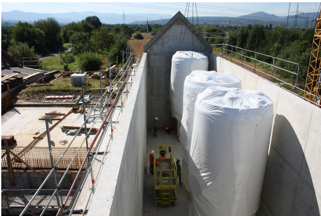
Bild 9: Die neuen Aktivkohlefilter zum Entfernen von PFC werden ins Wasserwerk Rauental eingesetzt. Jeder von ihnen hat einen Durchmesser von drei Meter und ist sieben Meter hoch. Bildnachweis: Stadtwerke Rastatt, Thomas Roth
