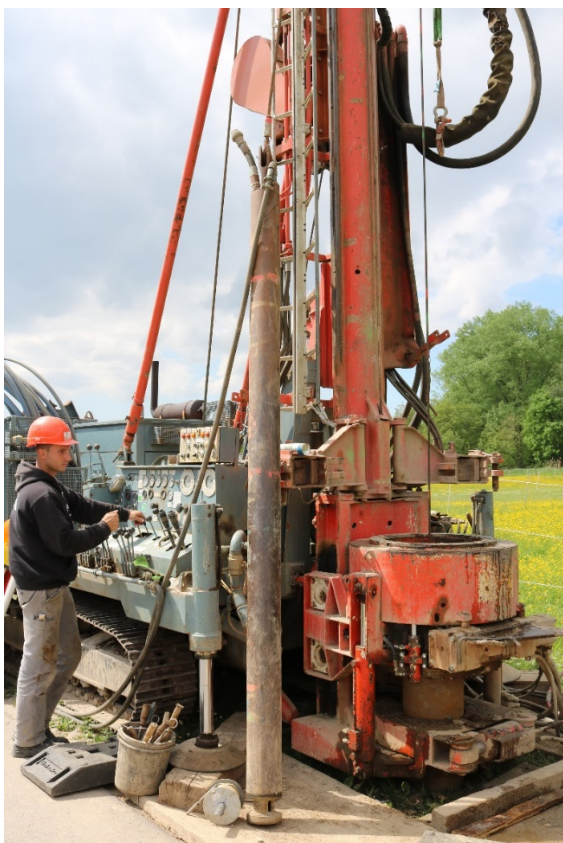
Bild 5: Bei Iffezheim und in der gesamten Region werden neue Messstellen für Grundwasseranalysen gebohrt. Bildnachweis: Stadtwerke Rastatt, Nele Kast-Wunsch
