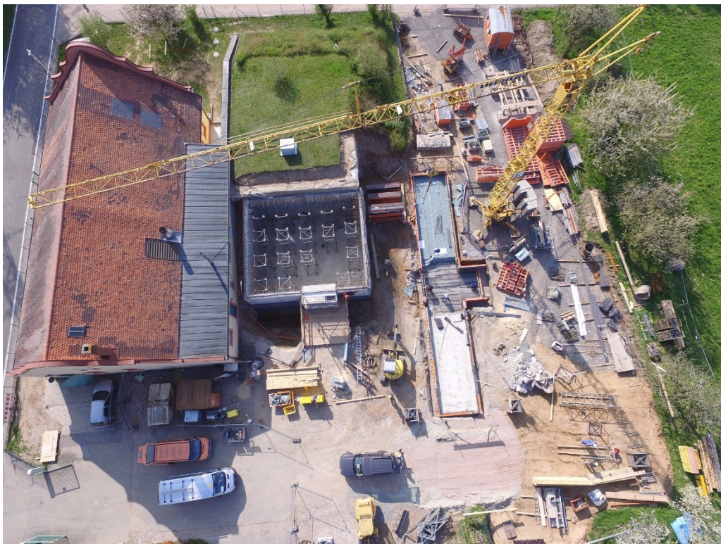
Bild 7: Umbau des Wasserwerks Raental mit Einbau von Aktivkohlefiltern zur Eliminierung von PFC, Blick von oben auf den Stand der Bauarbeiten 2017. Bildnachweis: Stadtwerke Rastatt, Thomas Roth
