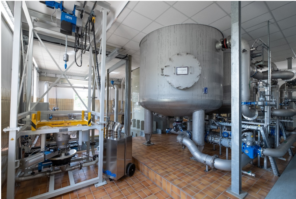
Bild 8: Die Grundwasseraufbereitungsanlage mit großen Aktivkohlefiltern des Wasserwerks Rauental. Seit 2018 ist das Wasserwerk wieder am Netz. Bildnachweis: Stadtwerke Rastatt, Oliver Hurst
