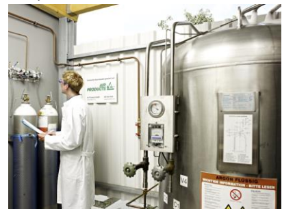
CryoEase® Tank von Air Products im Gaselager eines Umweltlabors
